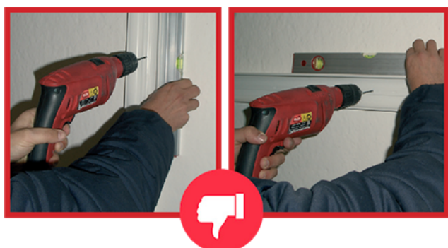
Kabelkanalinstallation ohne eingebaute Wasserwaage
