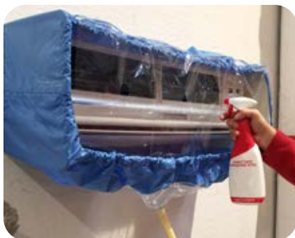
Pulizia batteria con telo di protezione applicato
