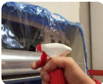
Pulizia batteria tramite foro inserimento spruzzino
